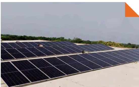
Seva Industries (60.18 kWp)
