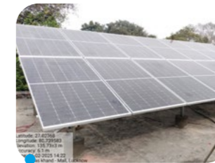
Block Mall - 15kW (Lucknow)
