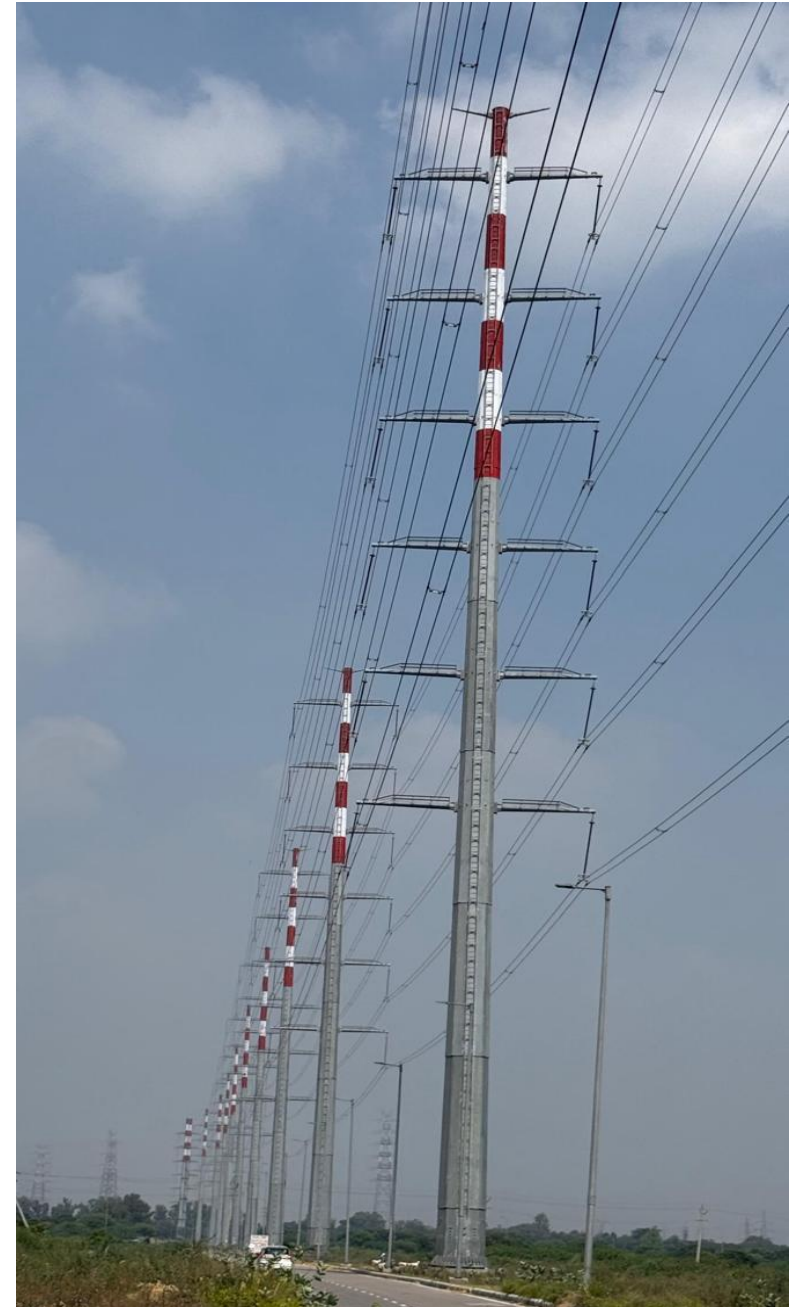
Actual picture - Monopole Towers
