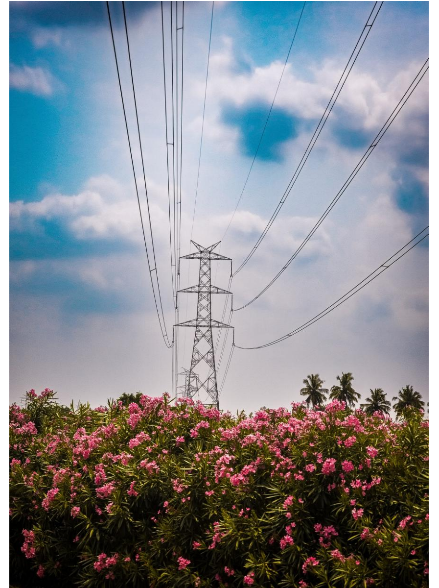
Actual picture: POWERGRID 400 kV Trichy/ Karaikudi - Madurai line
