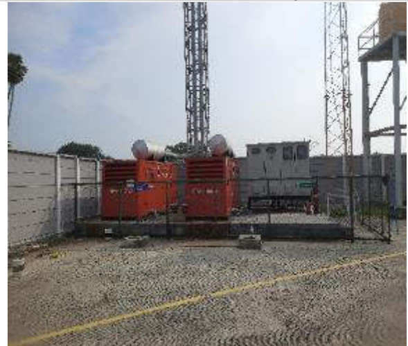
62) Diesel Generator Space
