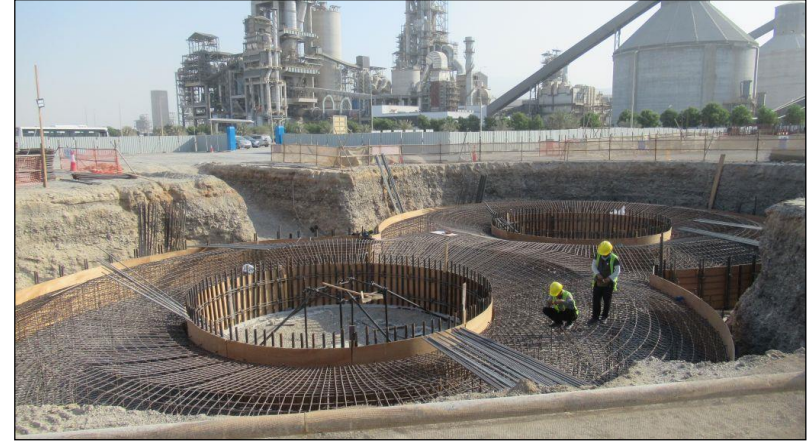
Fujairah : 1.65 MTPA GU- Cement silo
