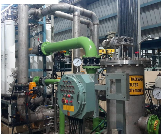
Effluent Recycling Plant Capacity : 2.4 MLD
