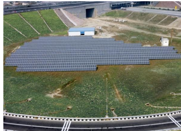
1.9 MW Solar Power Plant, Dasna Mehra
