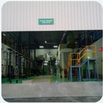
Effluent Treatment Plant (ETP)
