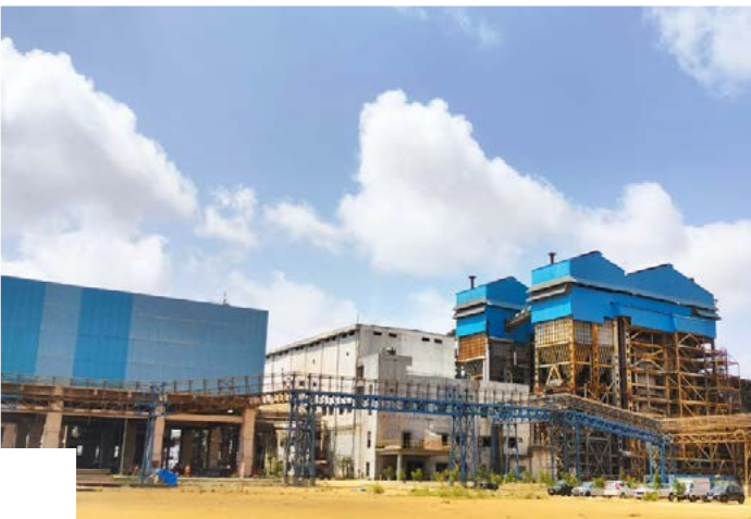
Captive Power Plant (Kutch)
